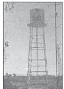
Tanque Elevado No. 4 Jaral
