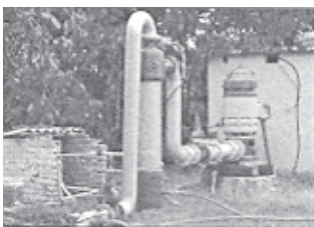
Pozo No. 1 "Ocampo"
