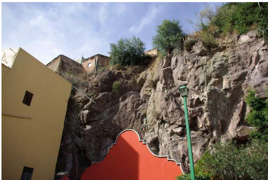
Fotografía 15. Punto de Riesgo
