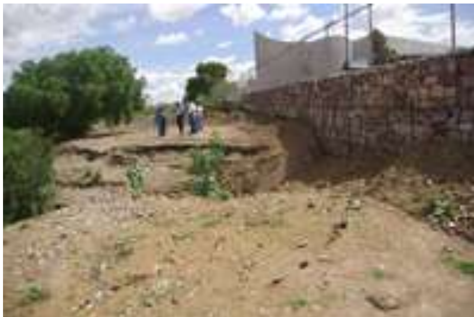
Fotografía 12. Área en riesgo de deslizamiento de ladera
