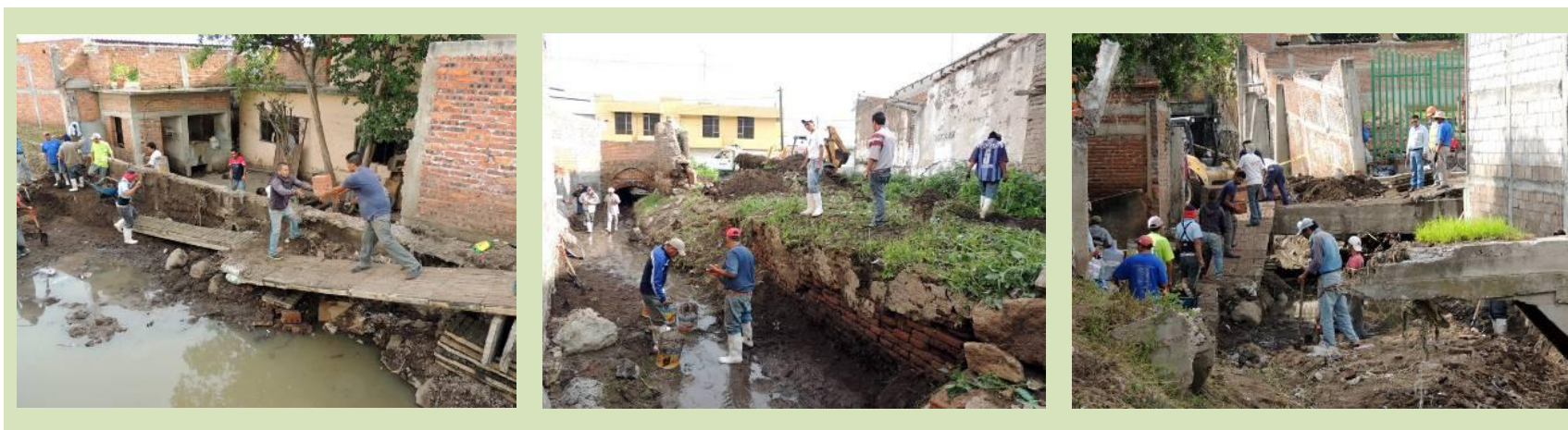
Imagen 20: Escurremientos no controlados Arroyo de la Barranca Fuente: Fotografías del Ayuntamiento Municipal del Desazolve del Arroyo de la Barranca.
